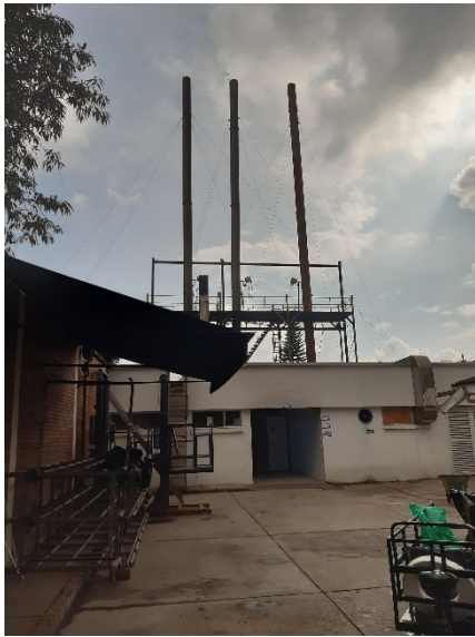
Fotografía 1. Ductos de los hornos
